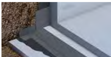
Losa de cimentación con barrera de radón Sistema RAD1 POLYDAN® 180-40 P Elast
